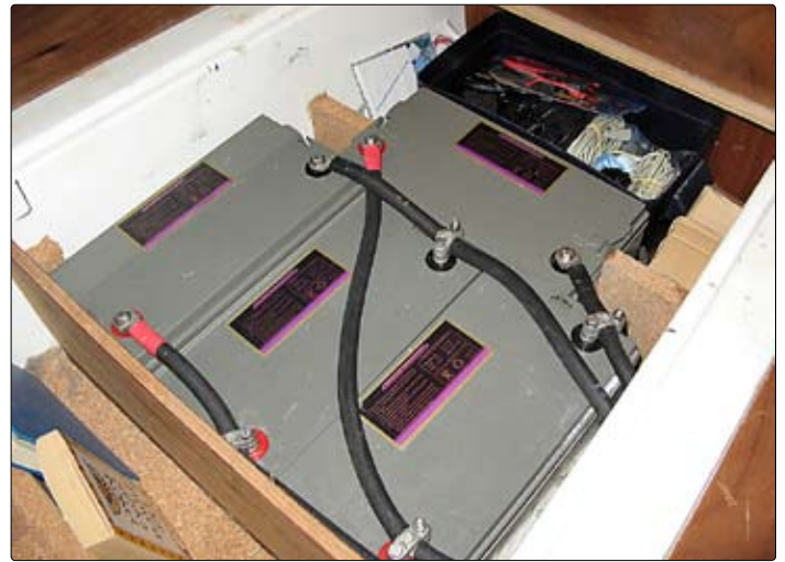
Batteribanken, 440Ah under huvudkudden i förpiken i snoOZze båten. Täta AGM-batterier (fiberbatterier) av märket Leoch. Vikt 4x32kg.
